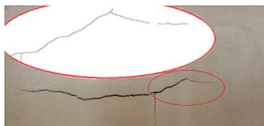
شکل ۱۶- بزرگ‌نمایی مقطعی از ترک برای مشاهده بهتر جزئیات
