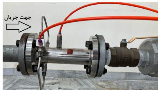
شکل ۳- محل نصب فلومتر مخروطی
