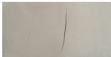
شکل ۱۸- پیدایش ترک در محل تمرکز تنش (نمای بالا)
