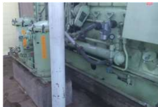
شکل ۲- مبدل حرارتی شرکت خطوط لوله و مخابرات نفت منطقه شمالشرق
